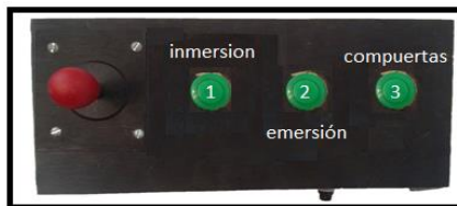
Fig. 10. Tablero de Control implementado.
